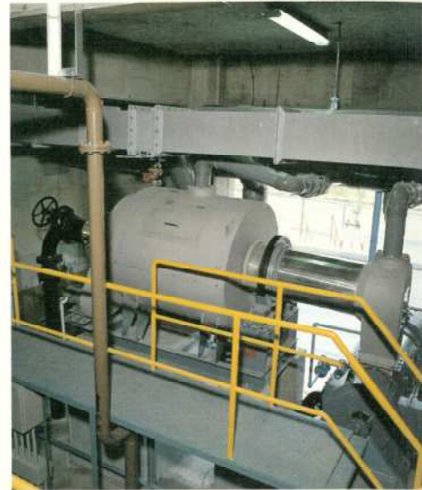
●前処理室 投入槽に投入したし尿は破碎機にて破碎され、ドラムスクリーンでろ過し、ろ液は貯留槽へ、し渣はスクリーブレスで脱水され、焼却炉へ送られます。
