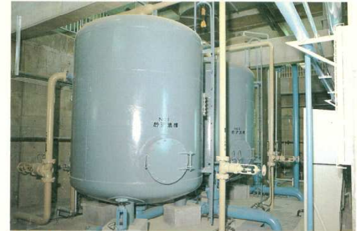
●砂ろ過器 オゾン処理水の濁質を除きます。
