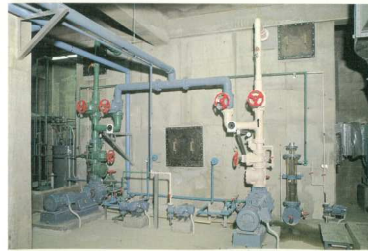
●酸-アルカリ脱臭塔 低濃度臭気・中濃度臭気を酸-アルカリ脱臭します。
