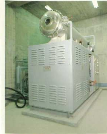
●オゾン発生機 凝集沈殿池処理水にオゾンを混入し処理水の脱色を行います。
